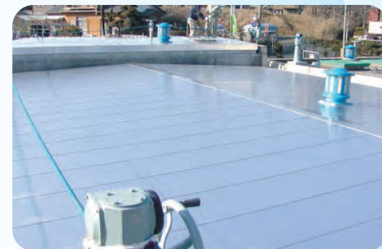
⑫ 流山市東部浄水場接触池
