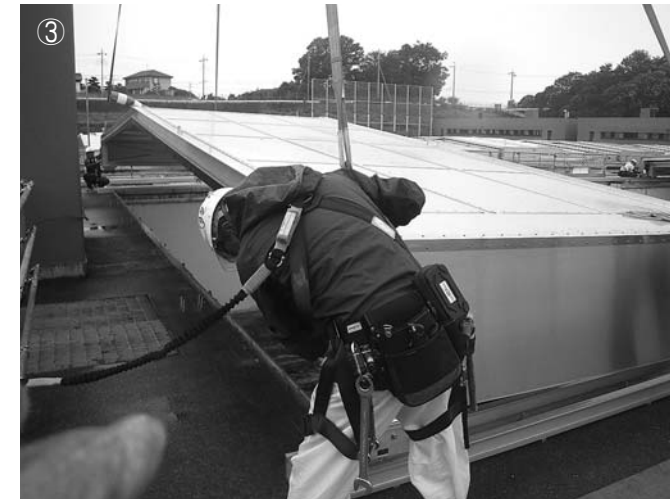
設置後に見られるろ過池
